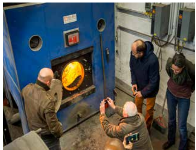
Blick in den Kessel – Verbrennung von Niedermoor-Biomasse | Foto: Tobias Dahms
